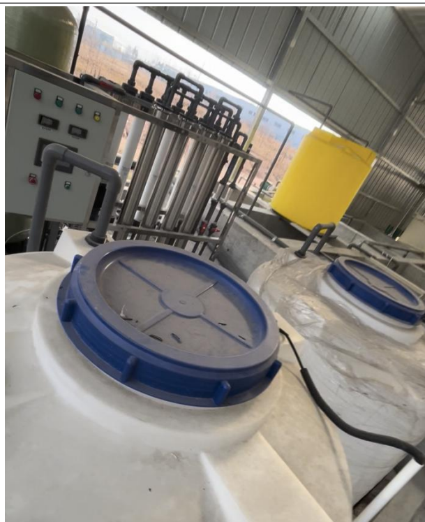
重金属生产废水中水回用系统
