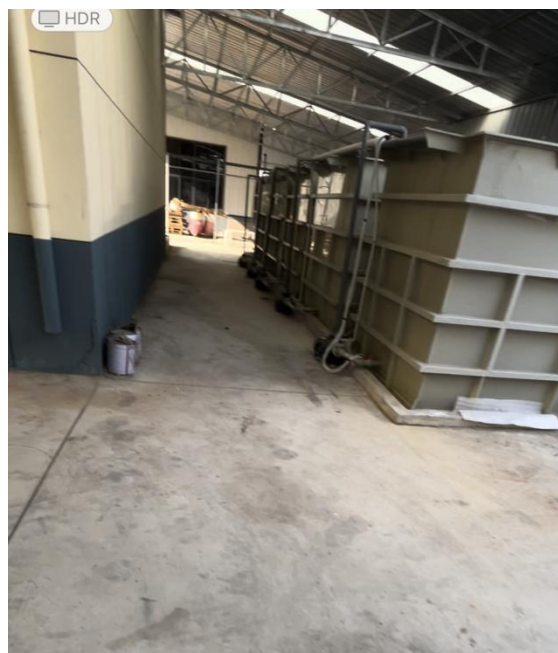
综合污水处理站
