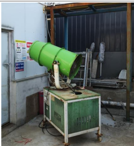
污水处理站雾炮机除臭
