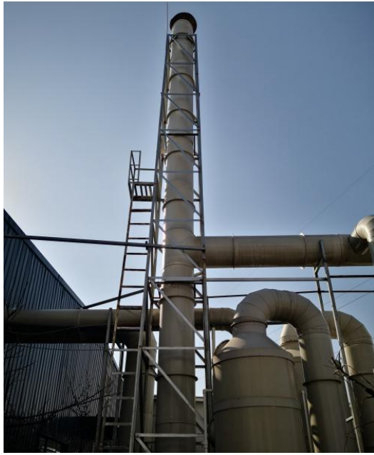
废气排气筒及采样平台
