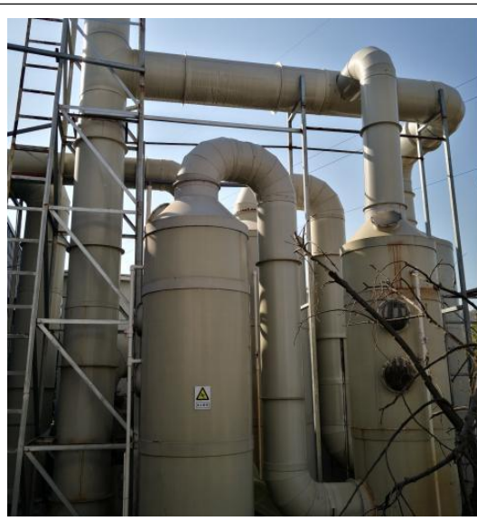
废气处理系统
