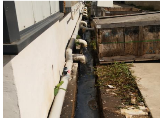
车间外排水沟（喷水织布废水）
