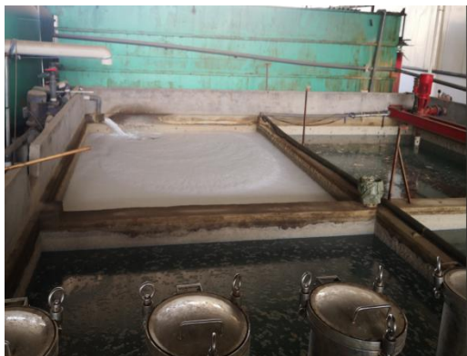
污水处理收集池
