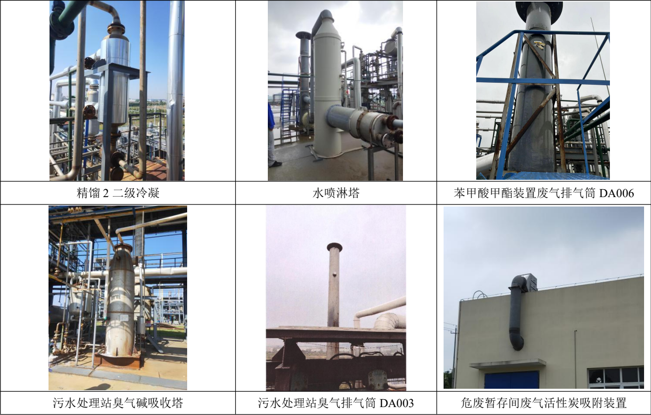
图 4.1-5 项目废气收集处理措施图
